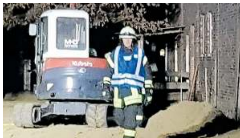
Mit diesem Minibagger beschädigte ein Seershausener eine Gasleitung. Die Feuerwehr hatte die Lage schnell im Griff. Foto: SG-Feuerwehr Meinersen/ Schaffhauser
